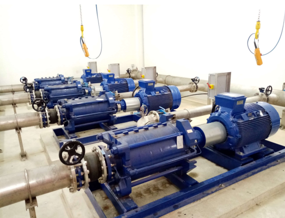
Système de pompage du Syndicat de transport d'eau potable de l'ouest de Limoges – 2009
