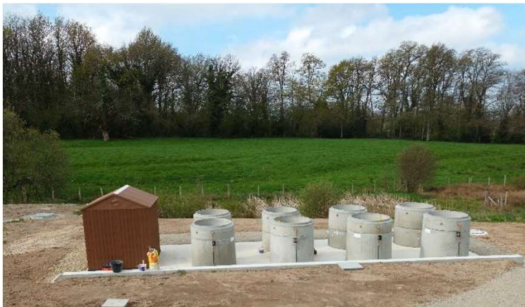
Démonstrateur innovant « Phosfer » pour le traitement des eaux usées des villages (Veyrac)
