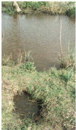
Terrier de ragondin, berge déstabilisée
