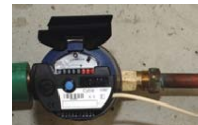
Les compteurs divisionnaires enregistrent la consommation d'eau d'un appartement dans un immeuble.
