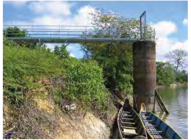
Prise d'eau par pompage en rivière à Maripasoula
