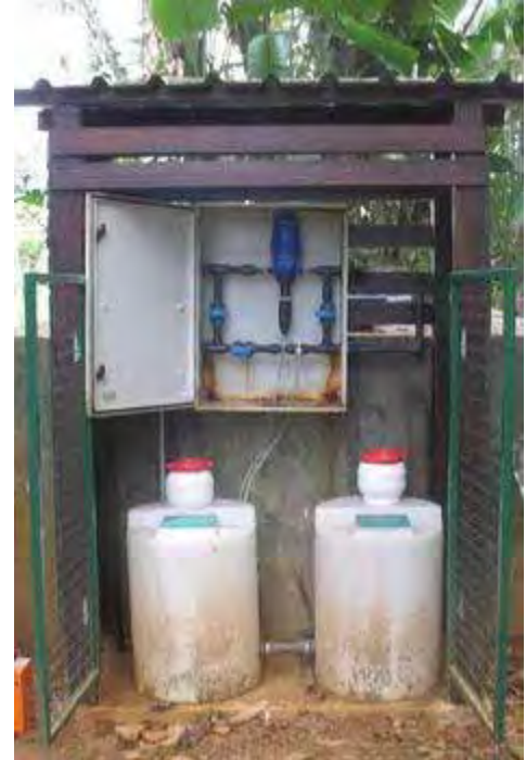
Local de chloration à Saïl
