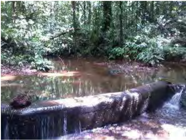
Prise d'eau en ligne à Kaw
