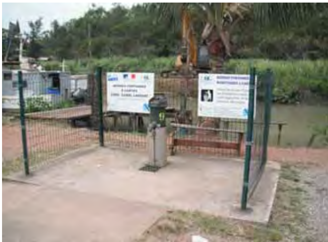
Borne-fontaine monétique installée au canal Laussat
