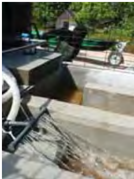
Recirculation de l'eau à Flèche
