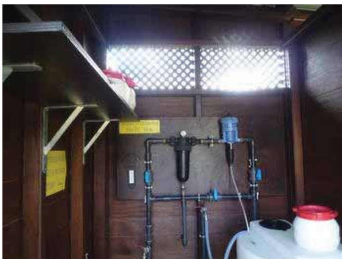
Local de chloration à Cayodé
