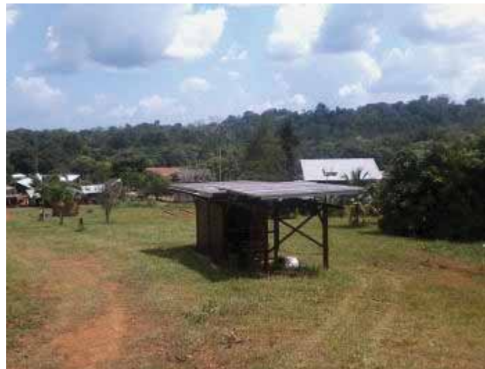
Local de chloration avec panneaux solaires photovoltaïque à Saül
