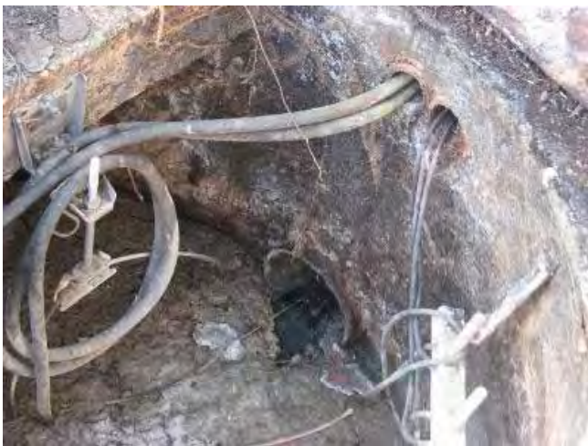
Rejet direct de trop-plein de poste de refoulement
