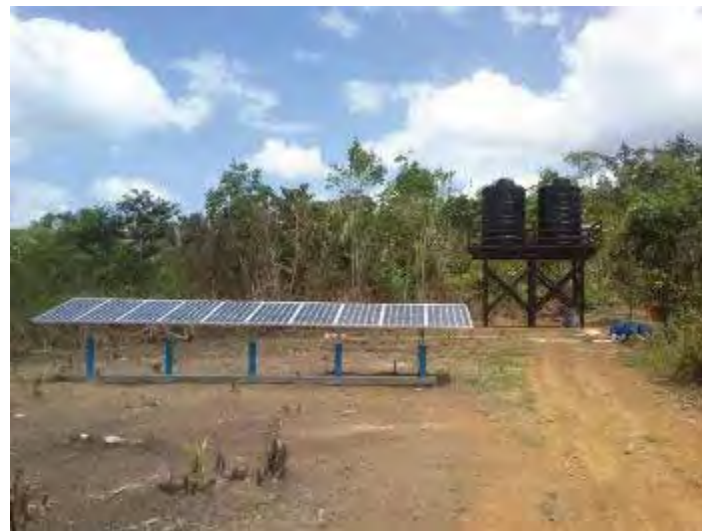
Réservoir et champ solaire photovoltaïque à Saint Soit
