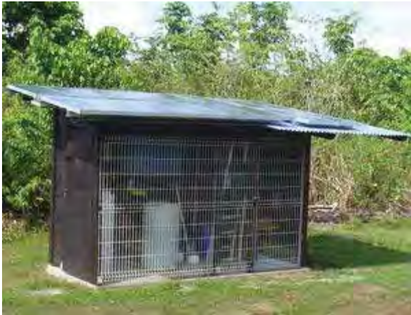
Local de chloration avec panneaux solaires photovoltaïque à Baboon Holo
