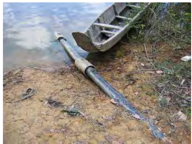
Rejet direct depuis un poste de refoulement
