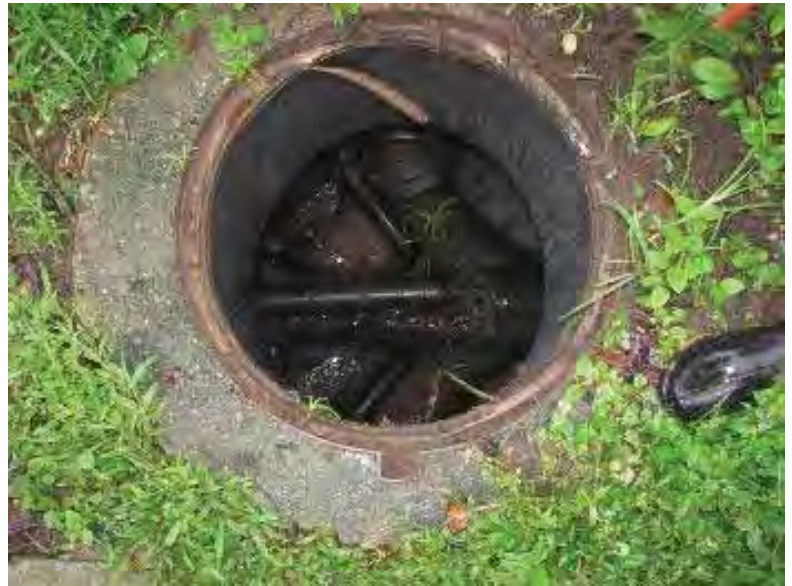
Regard d'assainissement de réseau collectif
