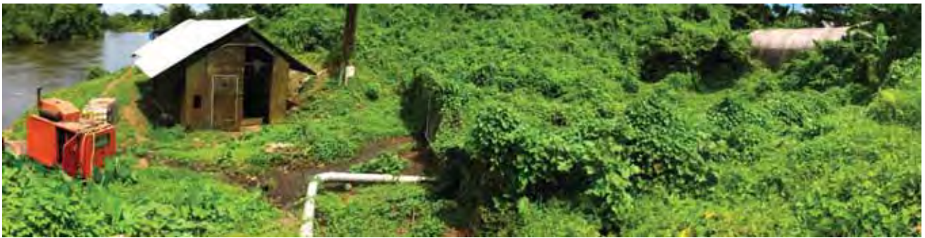
Station de traitement des eaux usées envahie par la végétation
