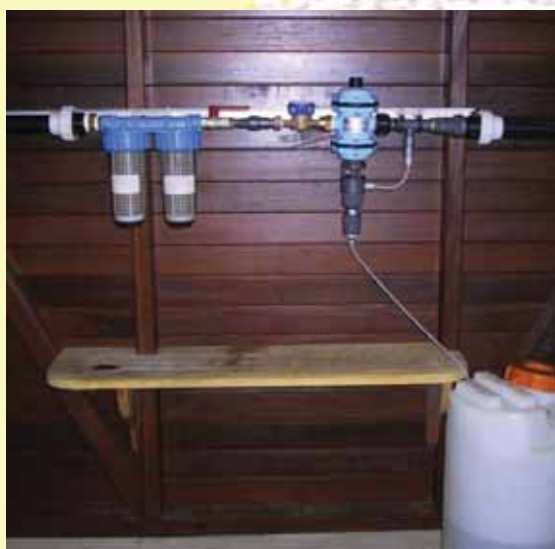
ANTECUM-PATA Abri de la chloration
