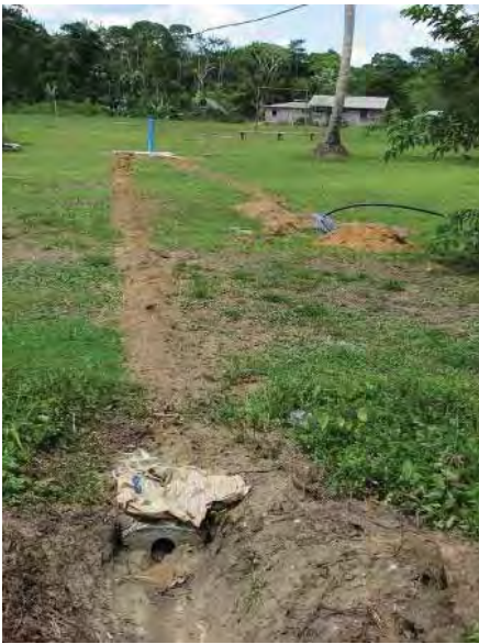
Évacuation de borne-fontaine
