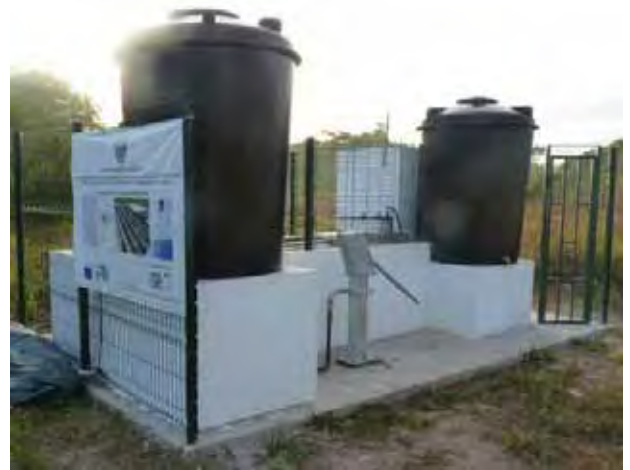
Vue générale de la station de Flèche
