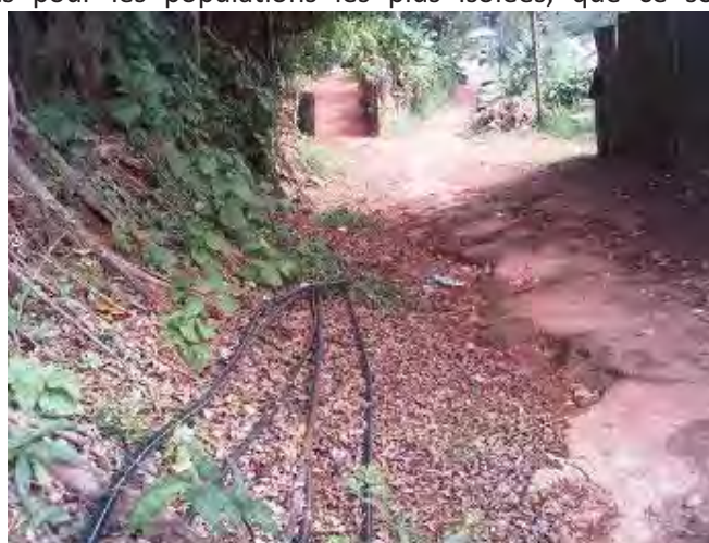
Réseau d'eau sur l'île de Cayenne
