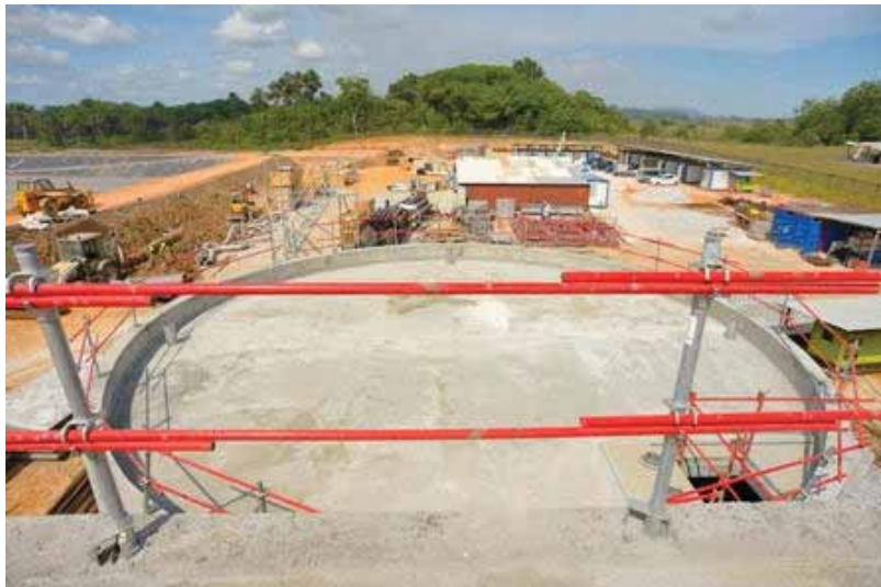
Usine d'eau de Matiti
