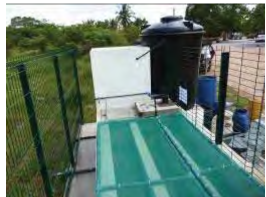
Massif filtrant et recirculation à Flèche
