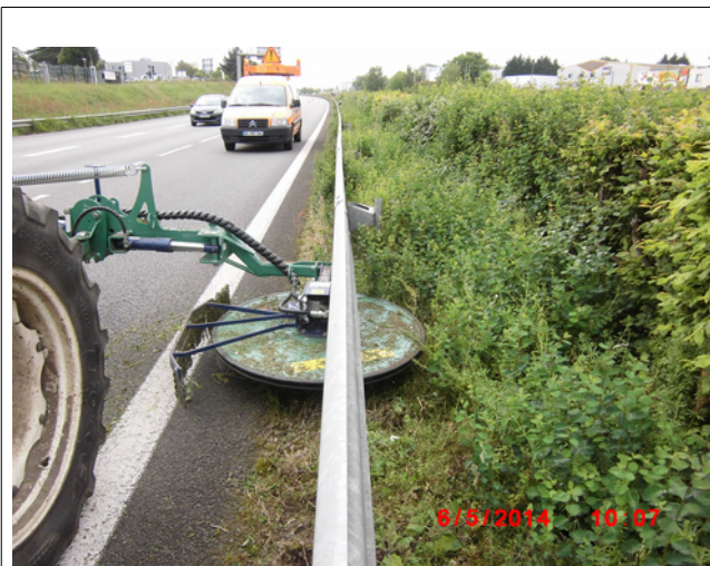
Photo n°24 : Faucheuse sous-glissière 1 bras (DIR Ouest)
