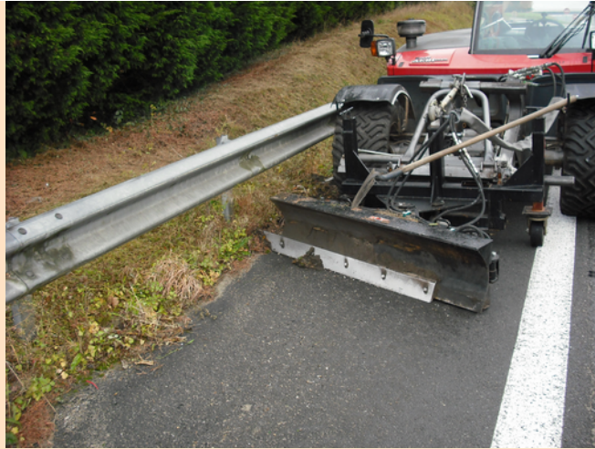
Photo n°17 : Dérèglement pied de glissière avec rabot (DIR Ouest)
