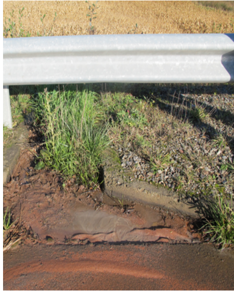
Photo n°18 : Descente d'eau obstruée par des dépôts et de la végétation (Cerema - Ouest)
