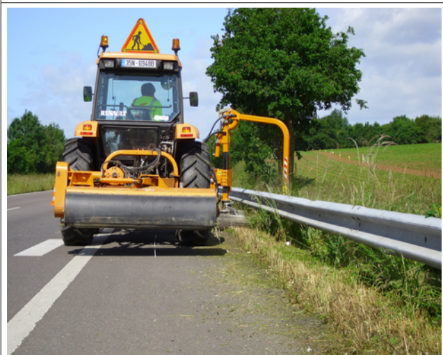
Photo n°26 : Faucheuse sous-glissière 2 bras (DIR Ouest)
