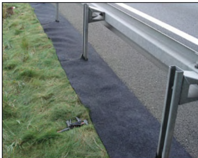
Photo n°3 : Revêtement de toiles non biodégradables sous glissière (DIR Massif Central)
